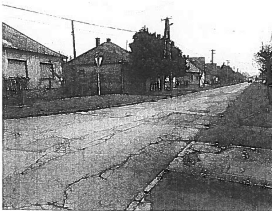
1. ábra: hálós repedés az Alapi Gáspár utcán
