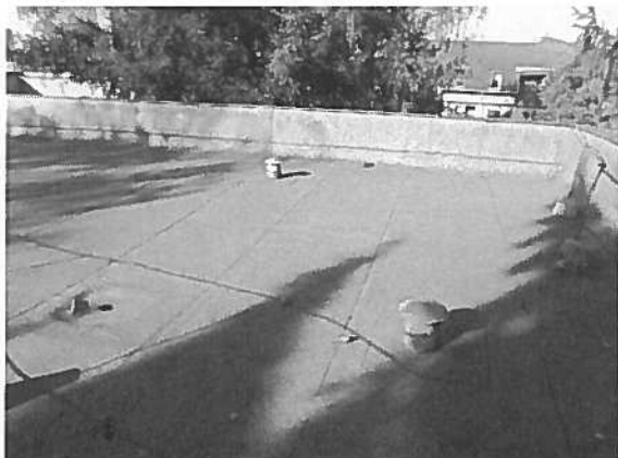
Lefolyónál szigetelés meggyűrődve
